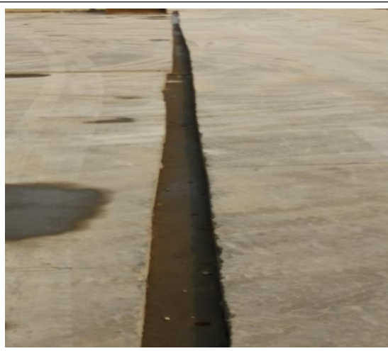
厂区地面排水沟
