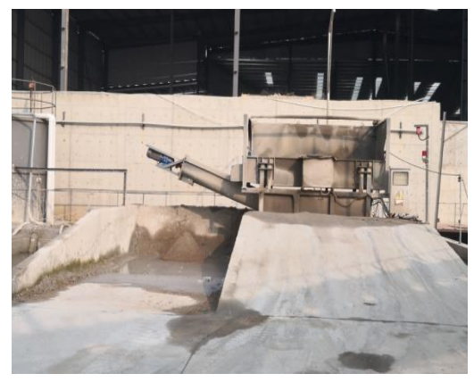
砂石分离机及沉淀池
