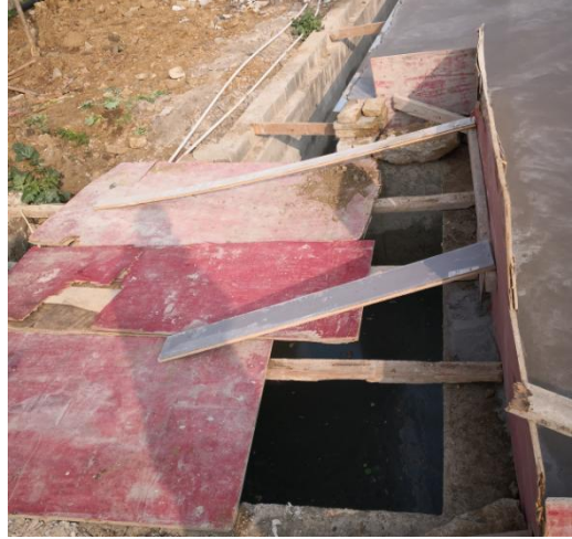
初期雨水缓冲池
