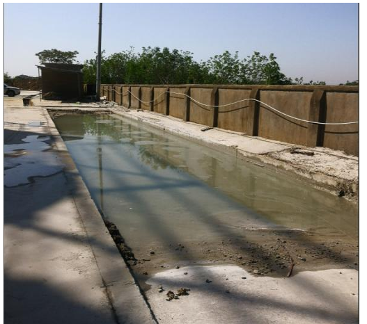
车辆冲洗沉淀池
