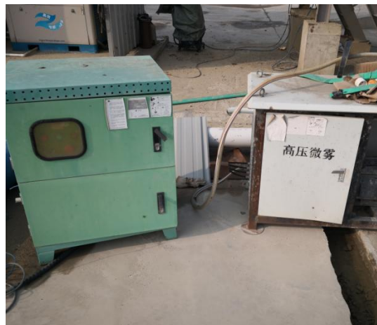
厂区喷雾装置
