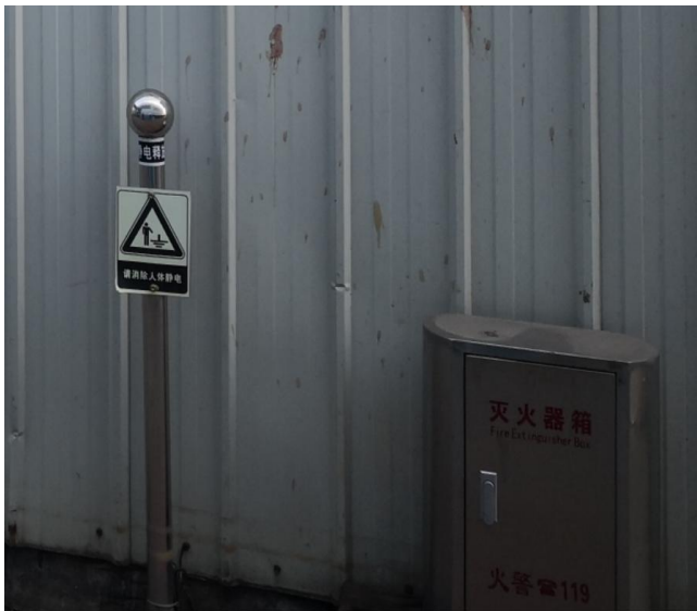
危废仓库防静电设施和灭火器
