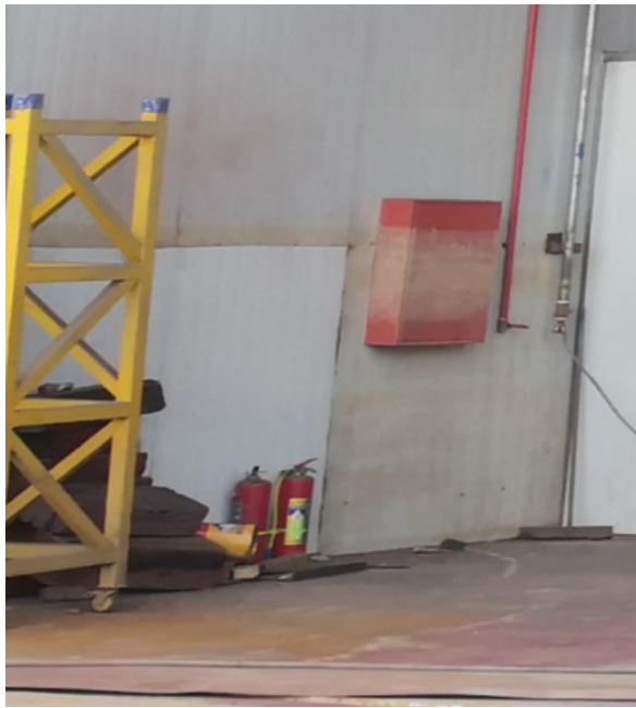
喷漆车间灭火器
