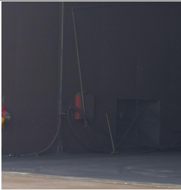
喷砂车间灭火器
