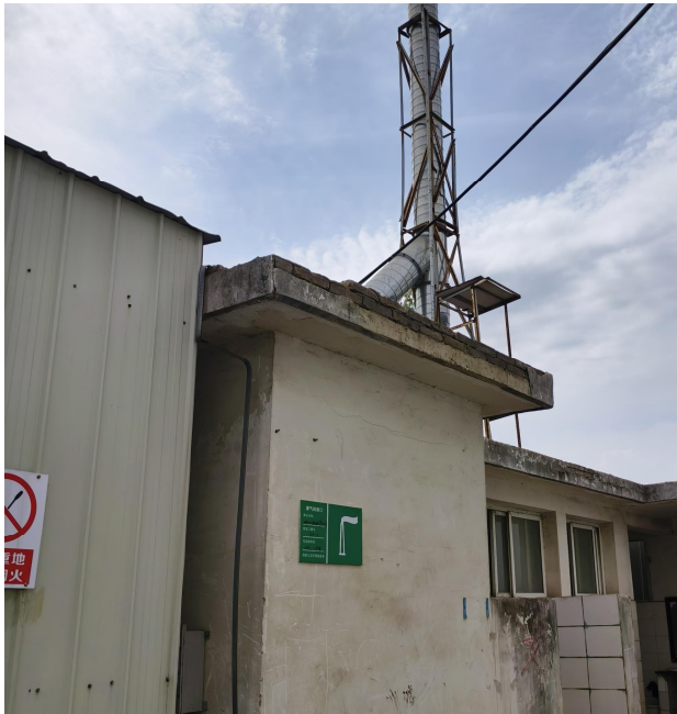
DA003 排气筒标识牌及监测孔
