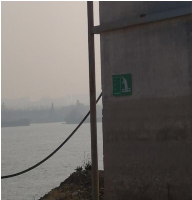
雨水排口标识牌
