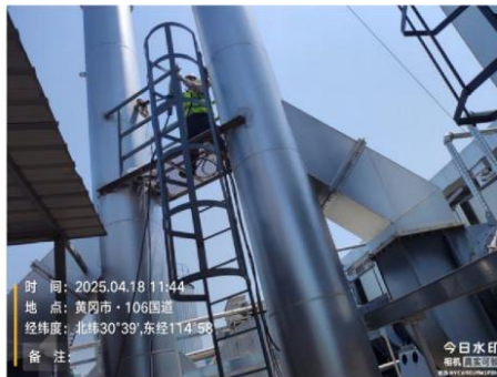
DA001 投料废气排放口◎YQ1
