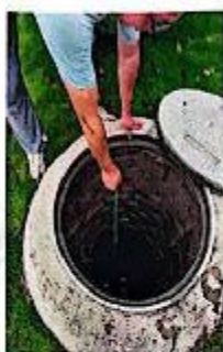
厂区内地下水井
