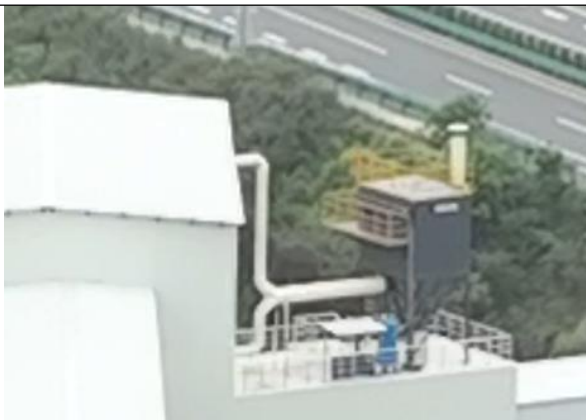
装卸口及转运站布袋除尘器
