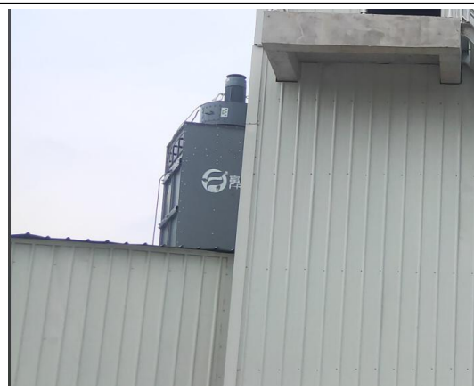
装卸口及转运站布袋除尘器
