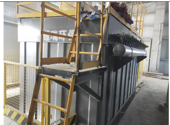
装卸口及转运站布袋除尘器
