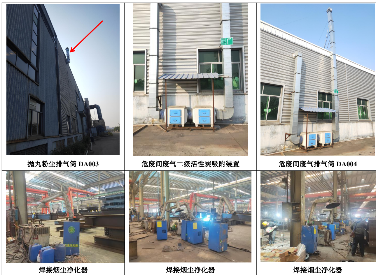
图 4.1-5 项目废气收集处理措施图
