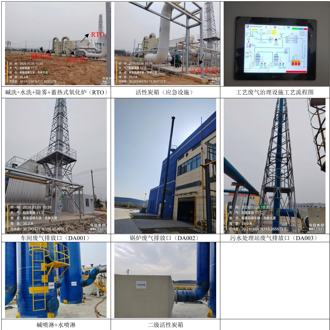
图 4.1-6 项目废气处理措施图
