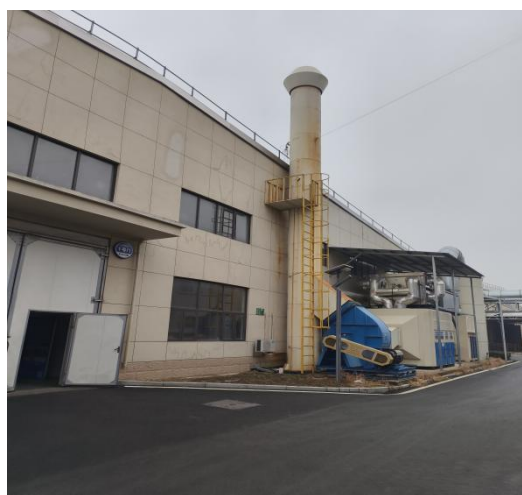
新喷漆线废气排气筒
