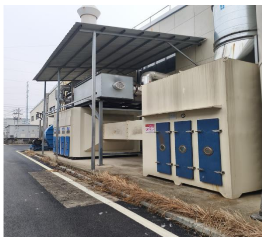
废气治理设施
