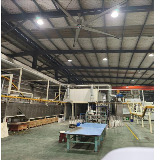
废气收集管道
