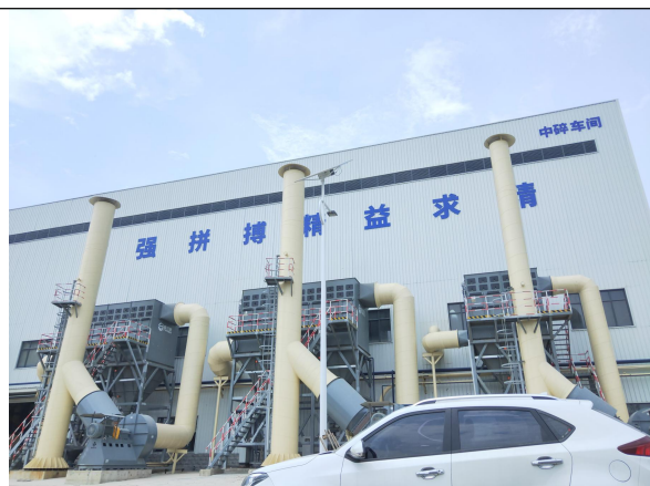
中碎车间粉尘烧结板除尘器+排气筒 (DA004-DA005)
