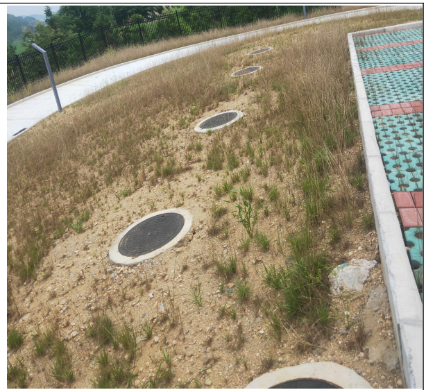
地埋一体化处理设施
