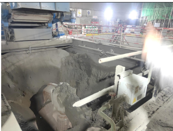
硐室粗碎工段喷雾装置
