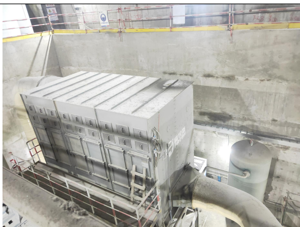
硐室粗碎工段烧结板除尘器
