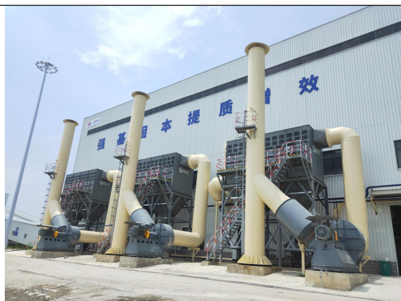
中碎车间粉尘烧结板除尘器+排气筒 (DA001-DA003)
