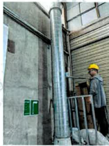
喷涂固化废气排放口
