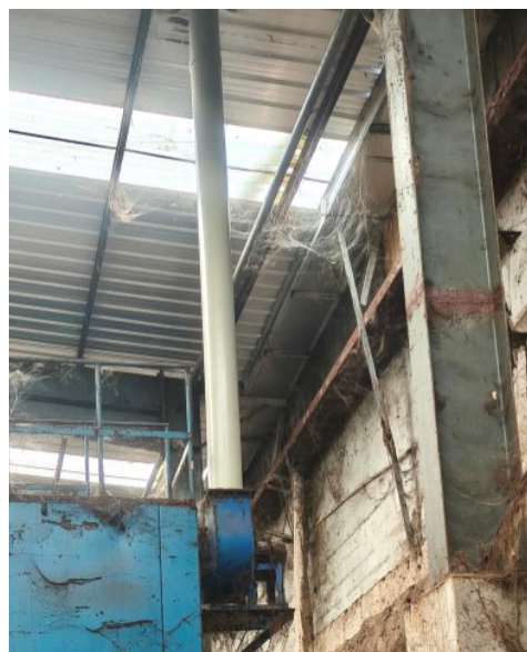
搅拌筛分废气排气筒
