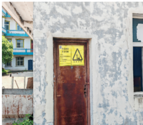
危废暂存间整体照片
