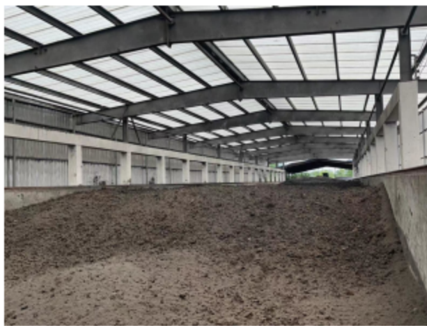
发酵车间封闭及废气收集管道
