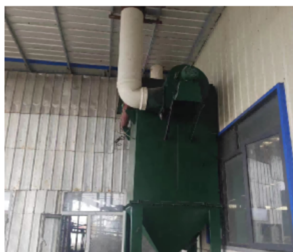
袋式除尘器及 15m 排气筒
