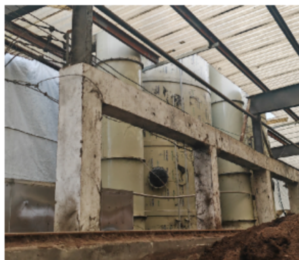
生物除臭塔及废气管道
