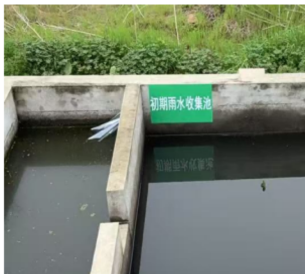
初期雨水收集池标识牌
