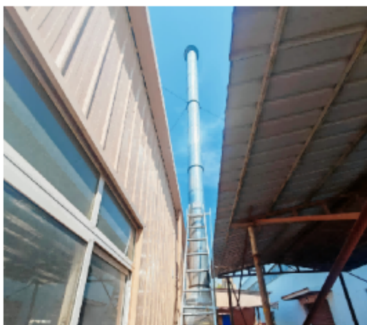
15m 高排气筒 (DA001)
