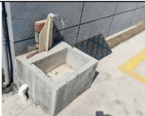
厂区生活废水收集池及管道
