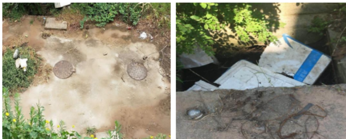
图 3-2 麻城市建鑫传动轴有限公司化粪池及污水排放口
