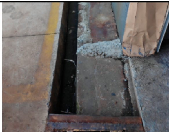
厂区雨水收集管网
