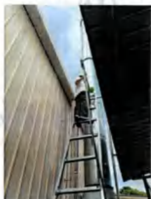
刷漆房废气排放口
