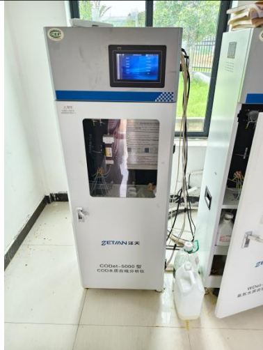
污水处理站出水COD在线监测设备
