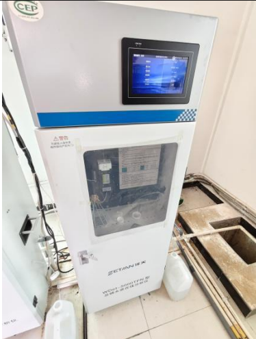
污水处理站出水总磷在线监测设备
