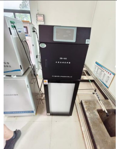
污水处理站出水自动采样器
