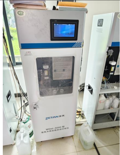
污水处理站出水氨氮在线监测设备
