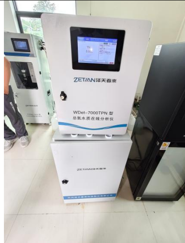
污水处理站出水总氮在线监测设备
