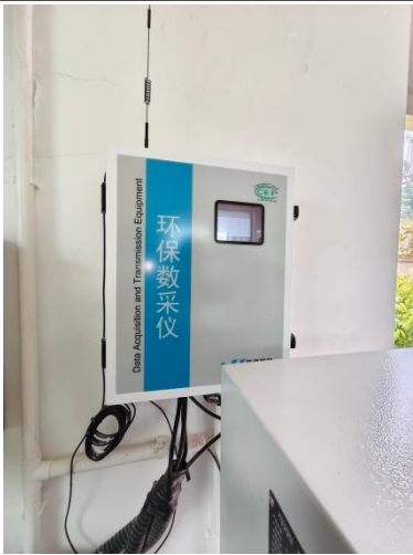
污水处理站出水数采仪在线监测设备
