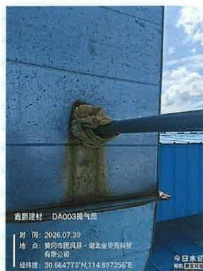
⑥抛光废气排气筒 DA003
