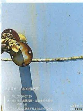
⑤混合搅拌、自动布料、高压压制、 加热固化、天然气燃烧废气排气筒DA002
