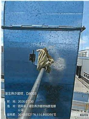
◎1混料废气排气筒DA001
