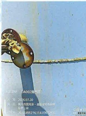
◎5混合搅拌、自动布料、高压压制、加热固化、天然气燃烧废气排气筒DA002
